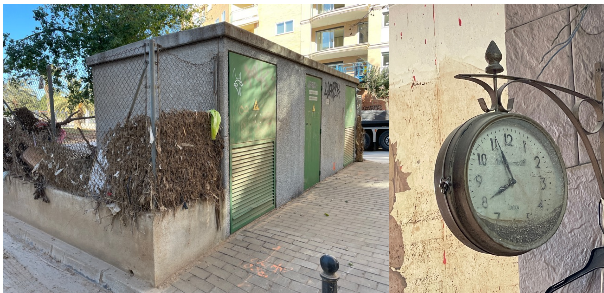
Fig. 10: Objetos arrastrados por las inundaciones en la valla junto a la infraestructura eléctrica, reloj parado en una cafetería dañada (Fekete, 9/1/2025)
