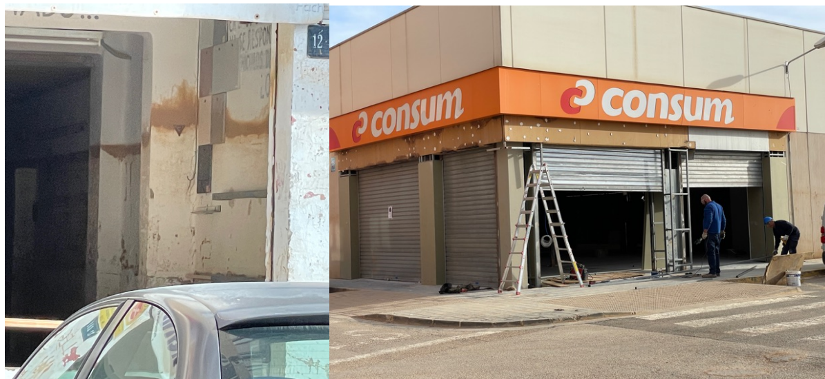
Fig. 3 Nivel de agua en la pared de un garaje y obras de renovación en un supermercado en Paiporta (Fekete, 8-1-2025)
