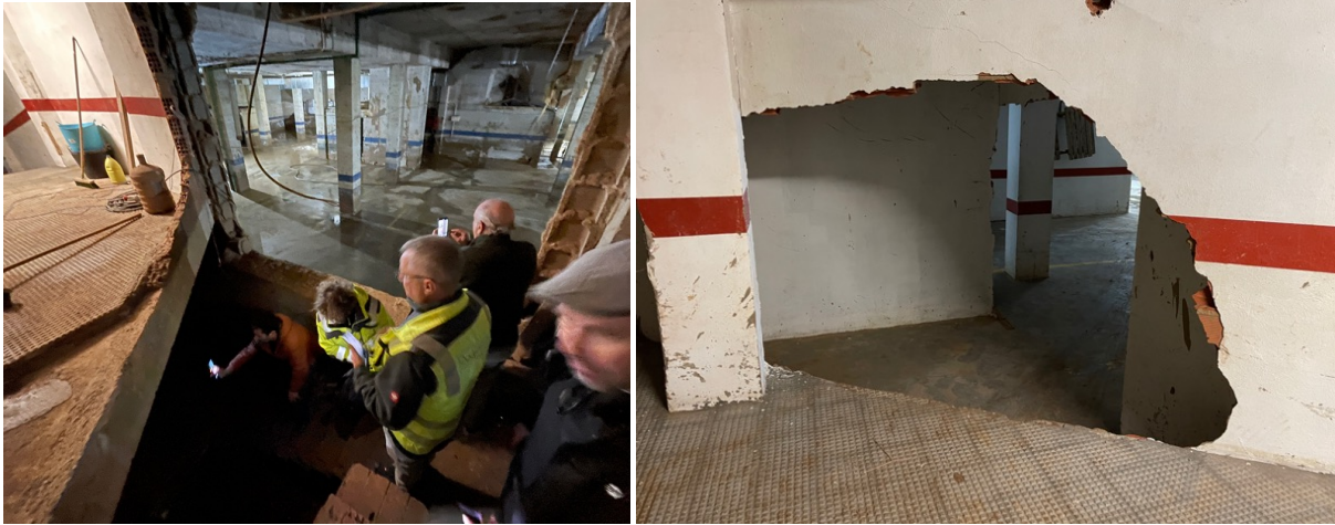
Abb. 7 Zerstörte 3-geschossige Tiefgaragen in Catarroja (Fekete, 9.1.2025)
