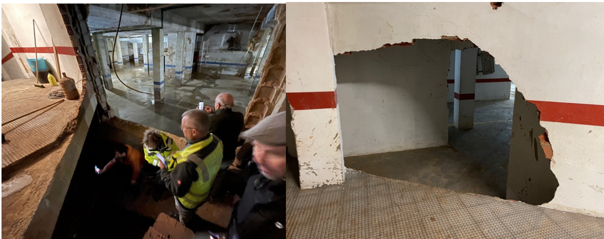
Fig. 7. Garajes subterráneos de tres plantas destruidos en Catarroja (Fekete, 9/1/2025)
