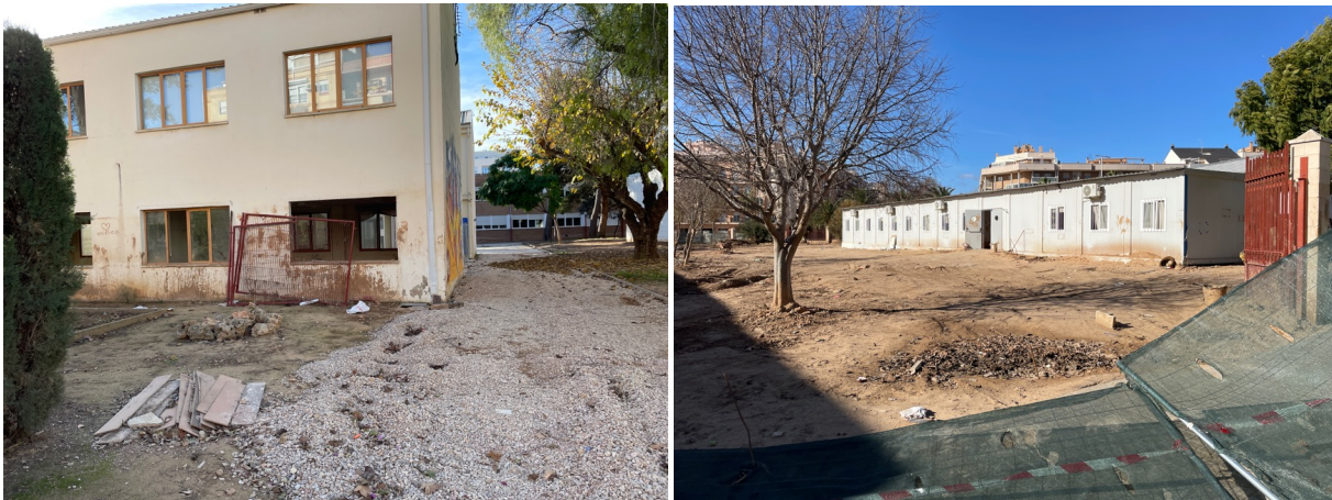
Abb. 9 Beschädigtes Schulgebäude und Ausweichgebäude aus Containern in Catarroja (Fekete, 9.1.2025)
